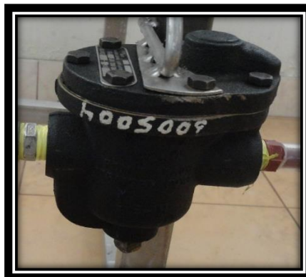
Ilustración 8 Trampa de vapor
