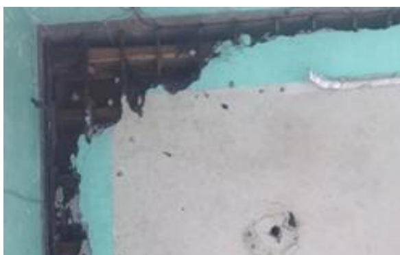
Figura 40. Revestimiento desgastado (techos)
