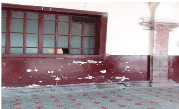
Figura 58. Deterioro en muros (grietas)
