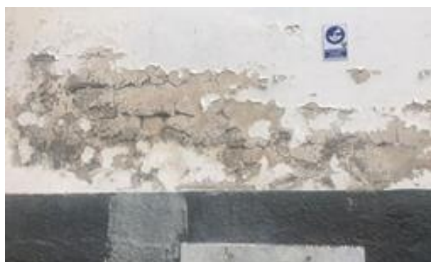
Figura 37. Revestimiento desgastado (muros)
