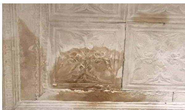
Figura 36. Humedad en techos
