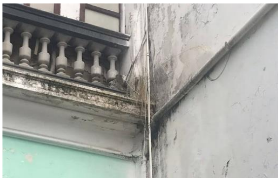
Figura 39. Desprendimiento de elementos (techo)
