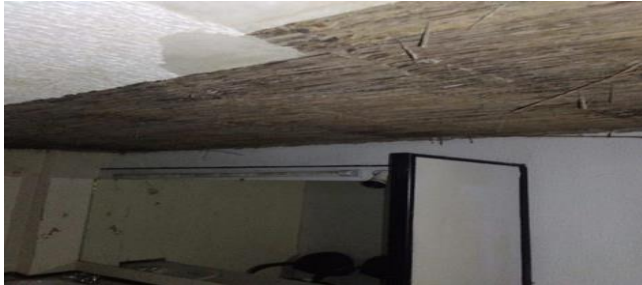
Figura 64. Problema de desprendimiento de elementos arquitectónicos
