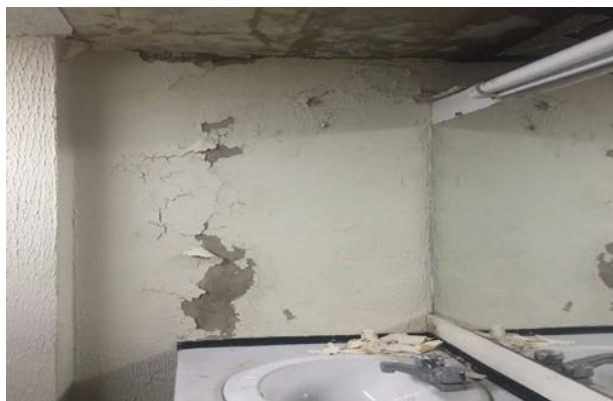
Figura 43. Desprendimiento de revestimiento (techo)
