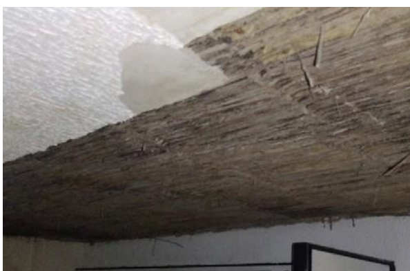
Figura 44. Humedad y Moho en techos
