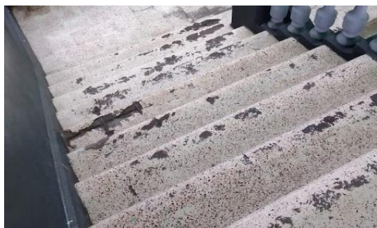
Figura 47. Desgaste de pisos de cemento
