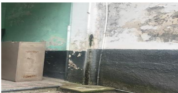
Figura 61. Problemas de humedad en muros
