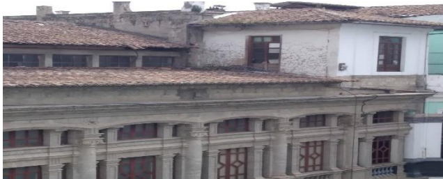
Figura 67. Problemas de mantenimiento, muros con plantas
