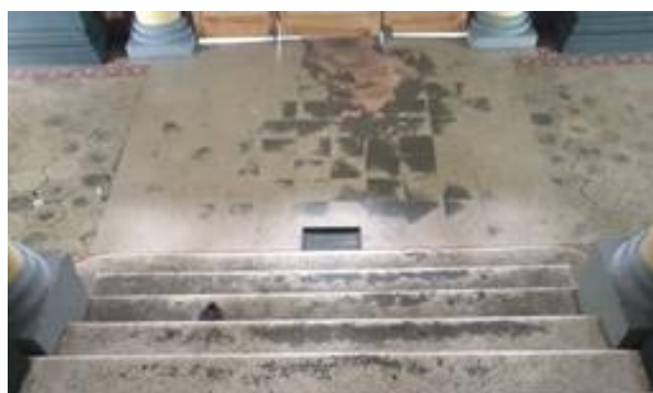
Figura 48. Suciedad antrópica erosión muros
